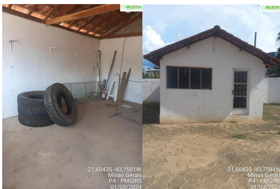
Figura 50 – Depósito de pneus inservíveis da prefeitura
